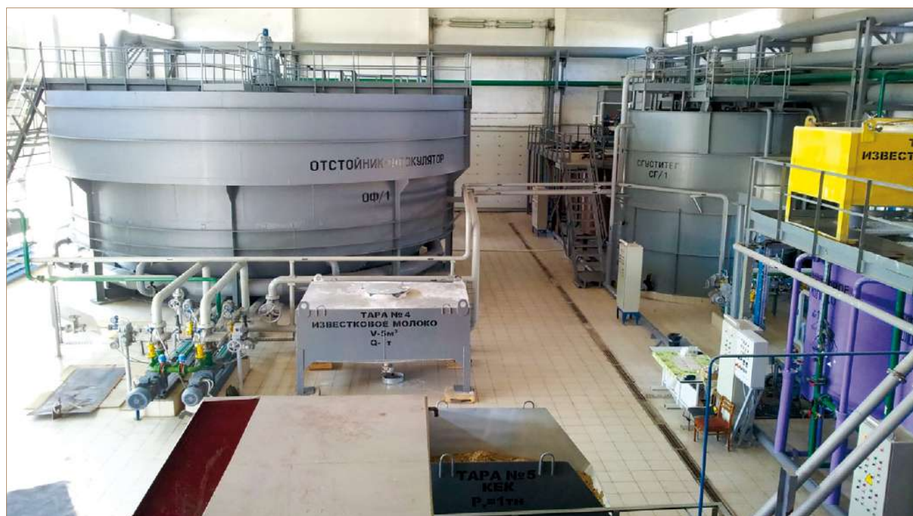
Рис. 1. Участок физико-химической очистки кислых сточных вод предприятия цветной металлургии. Отстойник-флокулятор ЭП ОФ и сгуститель осадка СГ ОФ.
